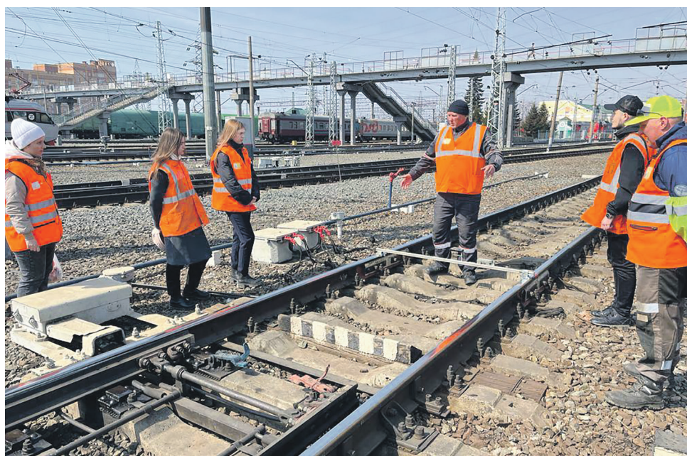
Профсоюзный актив и Совет молодежи Новосибирского центра организации работы железнодорожных станций посетили мастер-класс Новосибирской дистанции пути по ремонту стрелочного перевода
